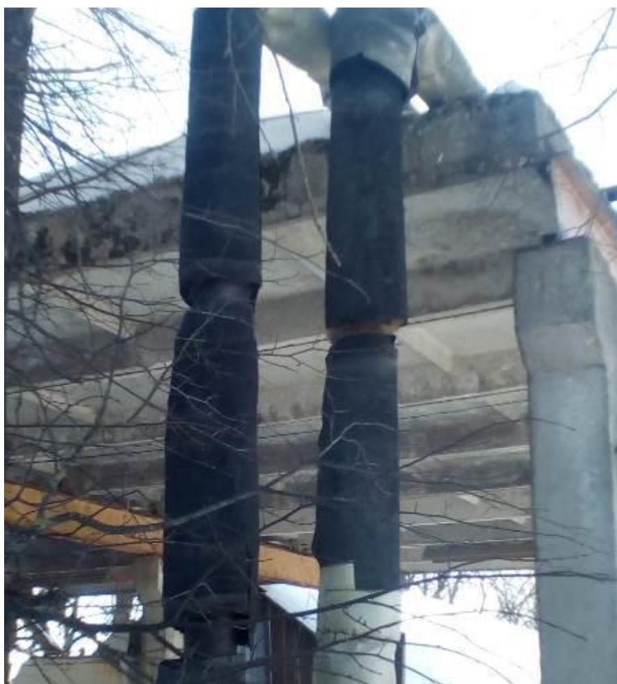
Рис. 3.23. Участок №4 тепловой сети котельной ул. Десантная
