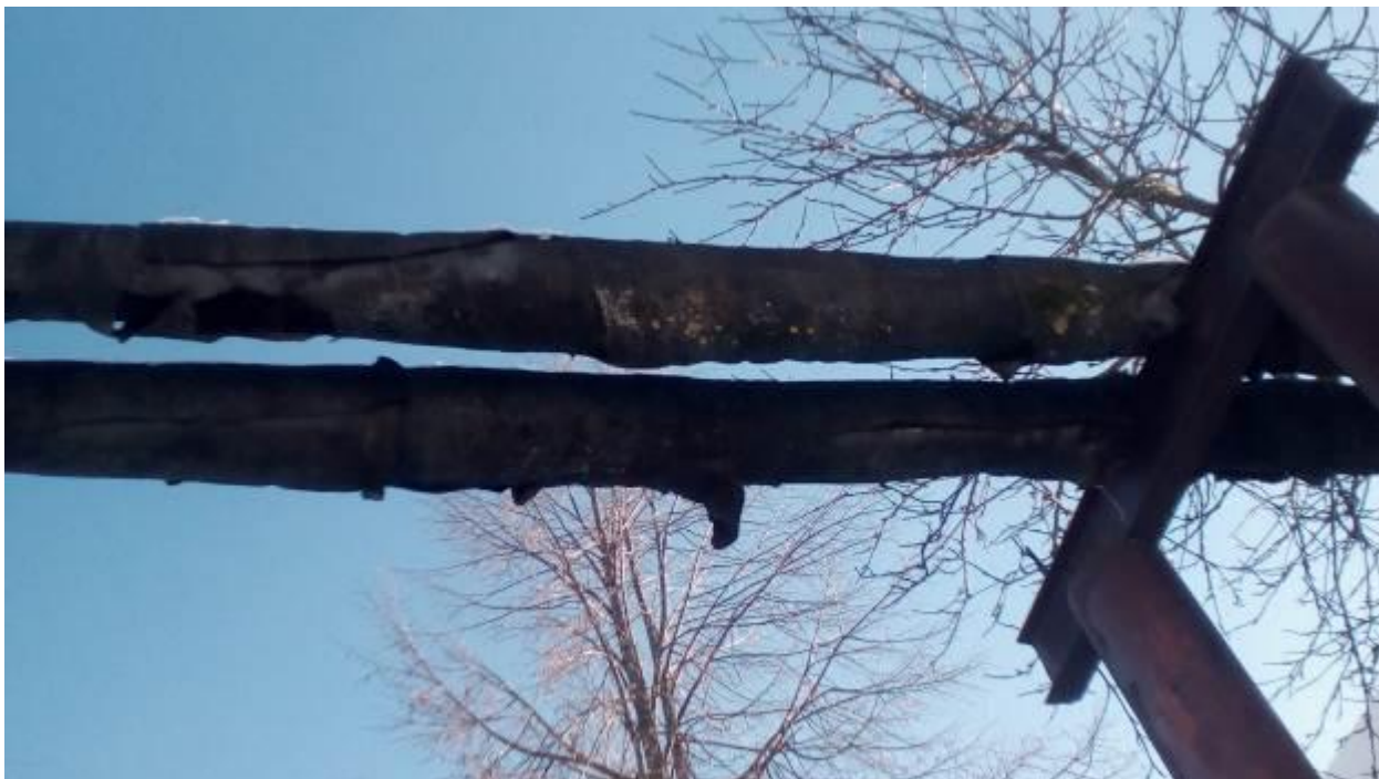
Рис. 3.31. Участок №21 тепловой сети котельной ул. Десантная
