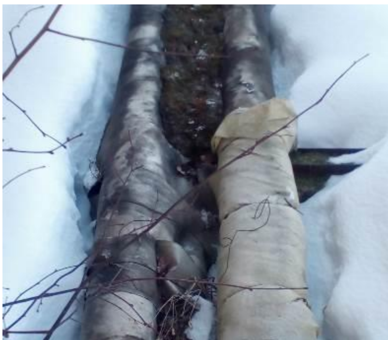
Рис. 3.22. Участок №4 тепловой сети котельной ул. Десантная
