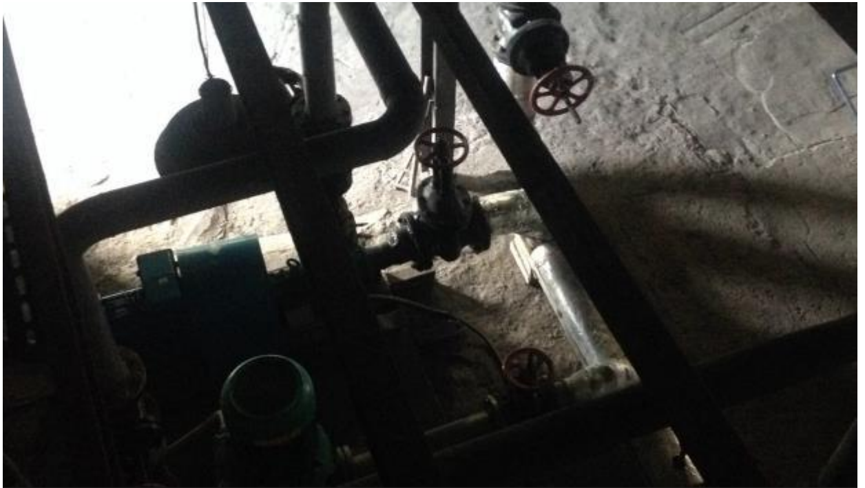
Рис. 3.26. Котельная ул. Десантная, насосная группа
