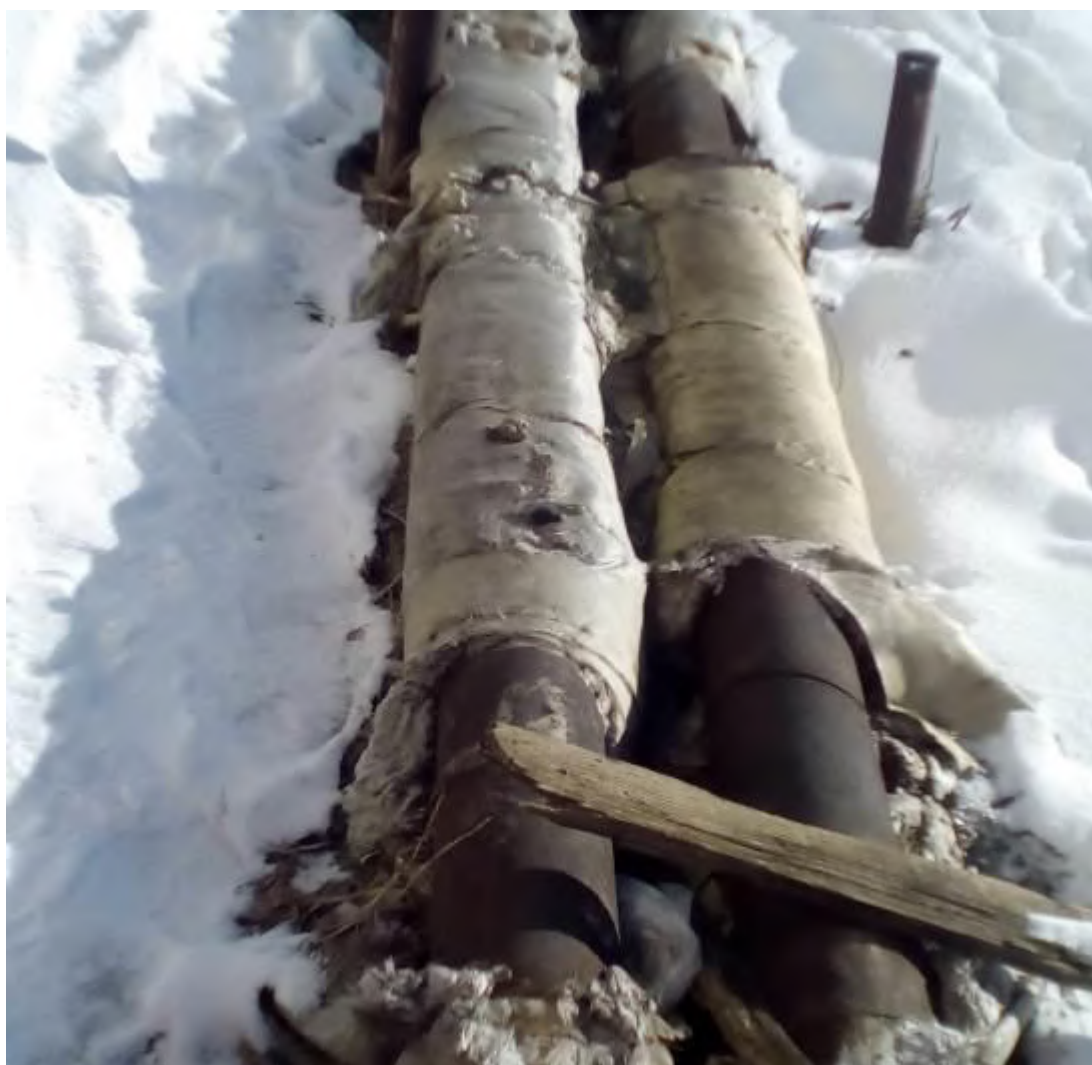
Рис. 3.17. Участок №13 тепловой сети котельной мкр-на ДОЗ
