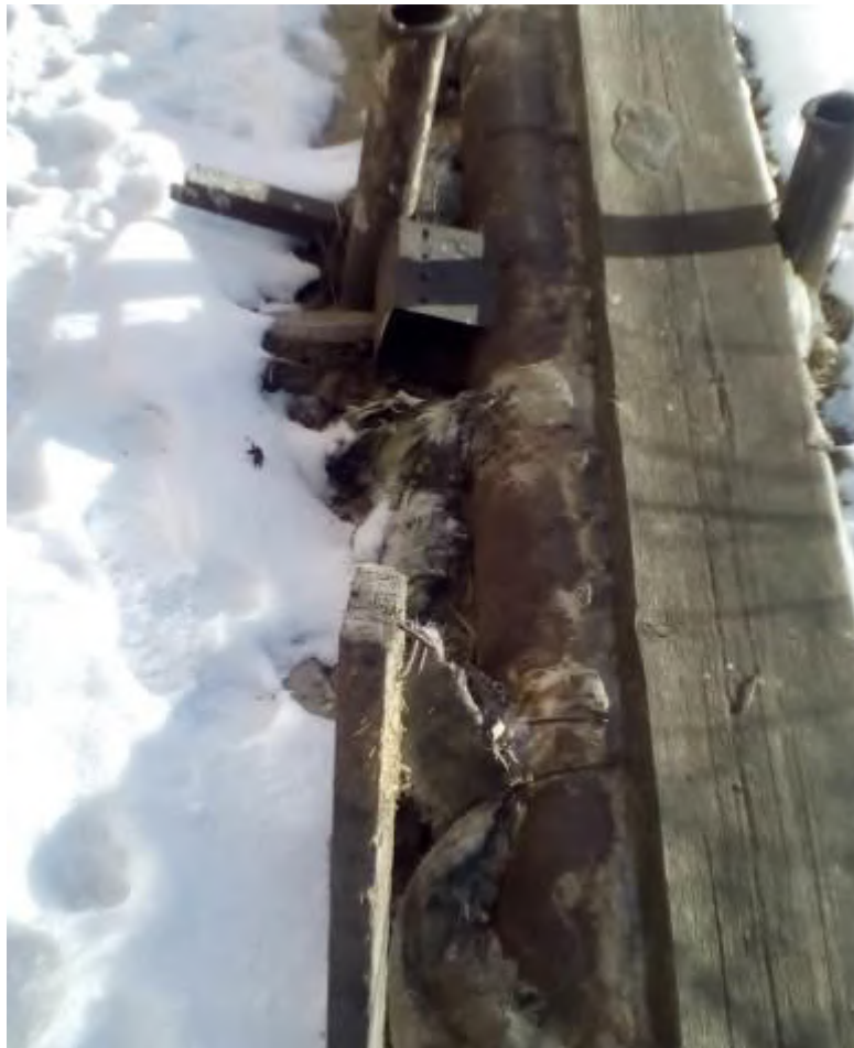
Рис. 3.16. Участок №13 тепловой сети котельной мкр-на ДОЗ
