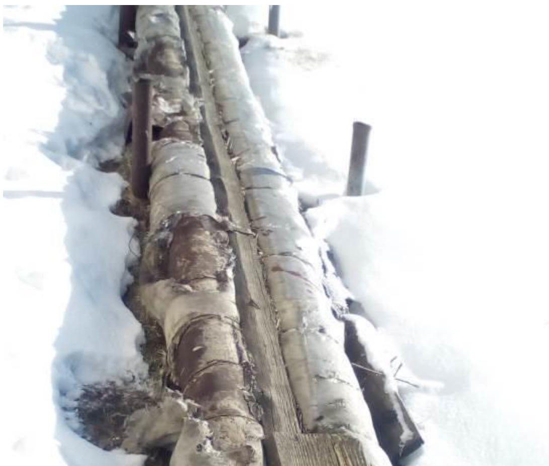
Рис. 3.14. Участок №11 тепловой сети котельной мкр-на ДОЗ
