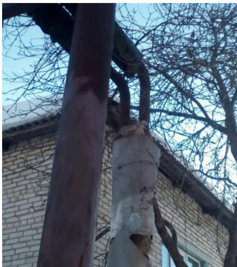
Рис. 3.29. Участок №16 тепловой сети котельной ул. Десантная
