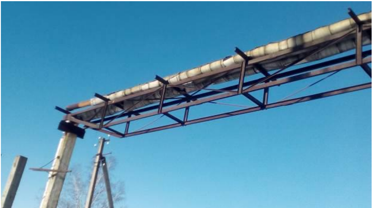
Рис. 3.10. Участок №4 тепловой сети котельной мкр-на ДОЗ
