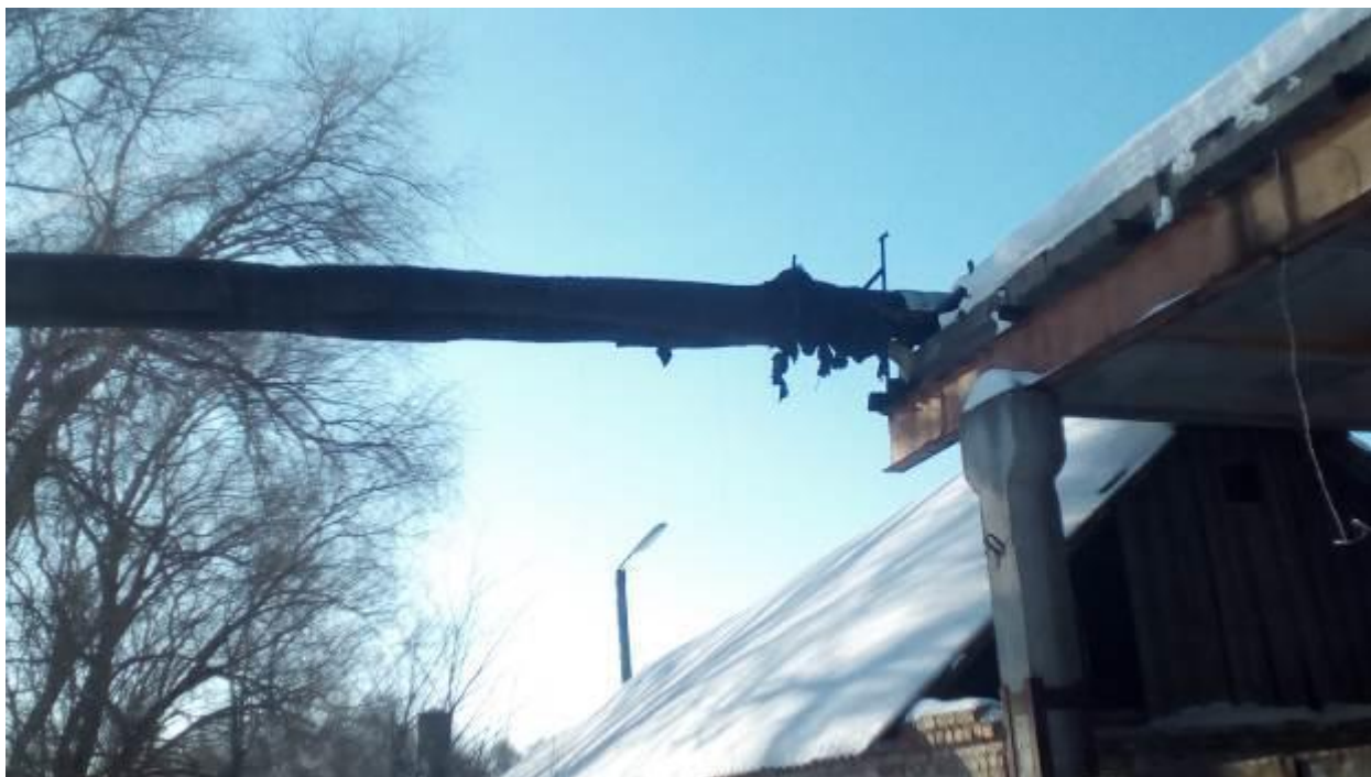
Рис. 3.27. Участок №13 тепловой сети котельной ул. Десантная
