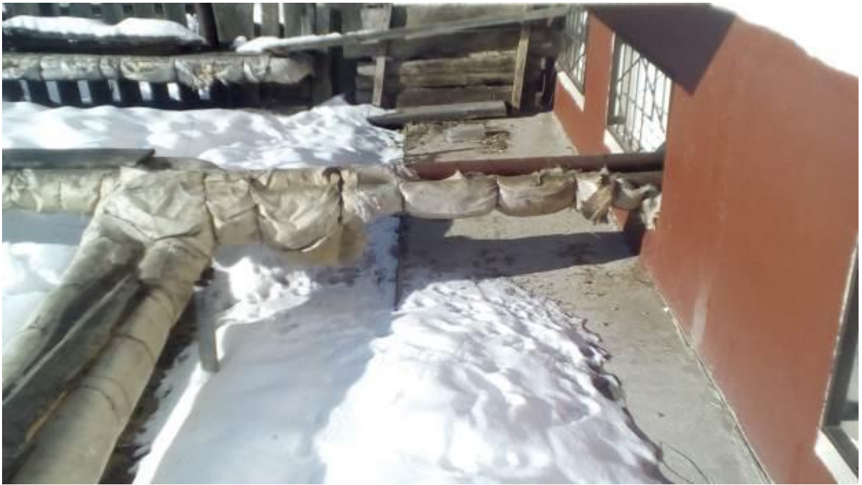
Рис. 3.15. Участок №12 тепловой сети котельной мкр-на ДОЗ
