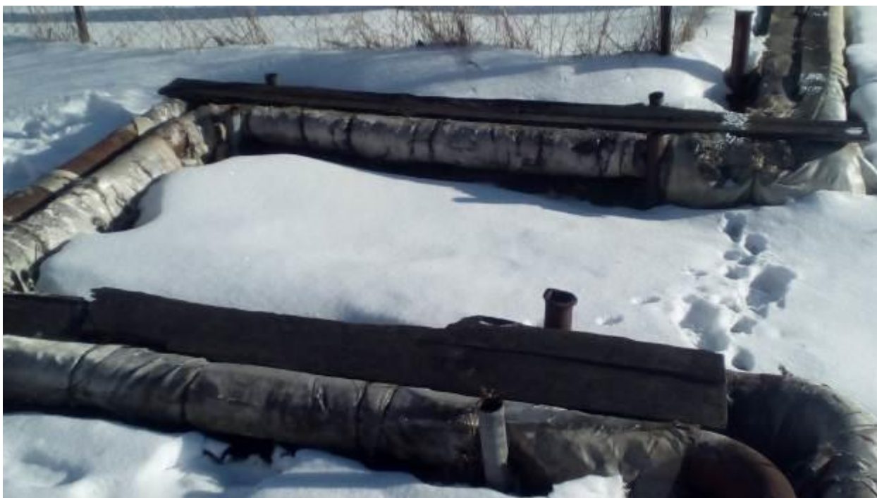
Рис. 3.13. Участок №10 тепловой сети котельной мкр-на ДОЗ
