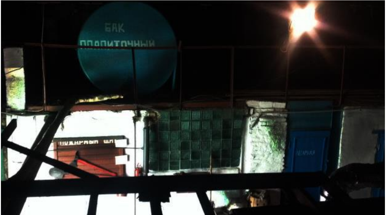
Рис. 3.25. Котельная ул. Десантная, вид изнутри
