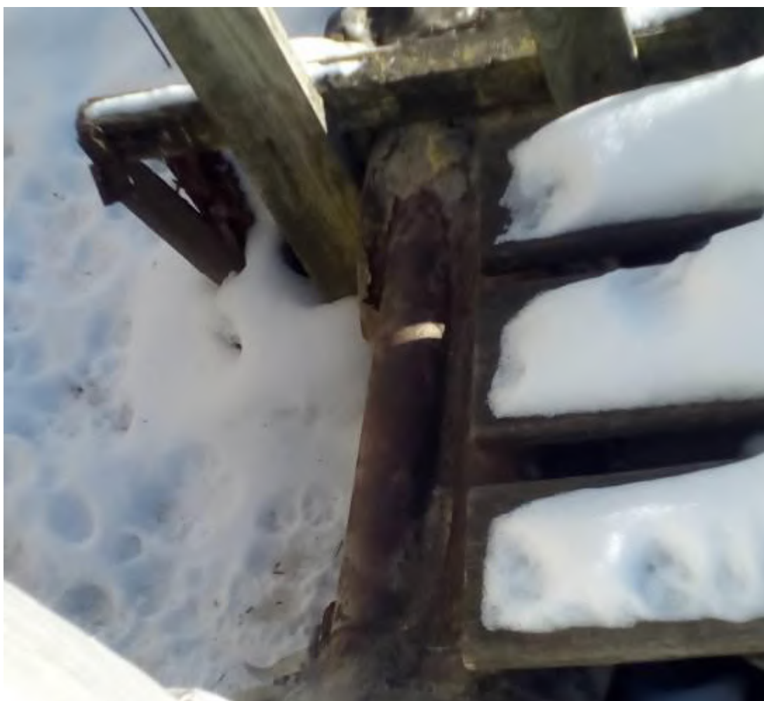
Рис. 3.28. Участок №15 тепловой сети котельной ул. Десантная
