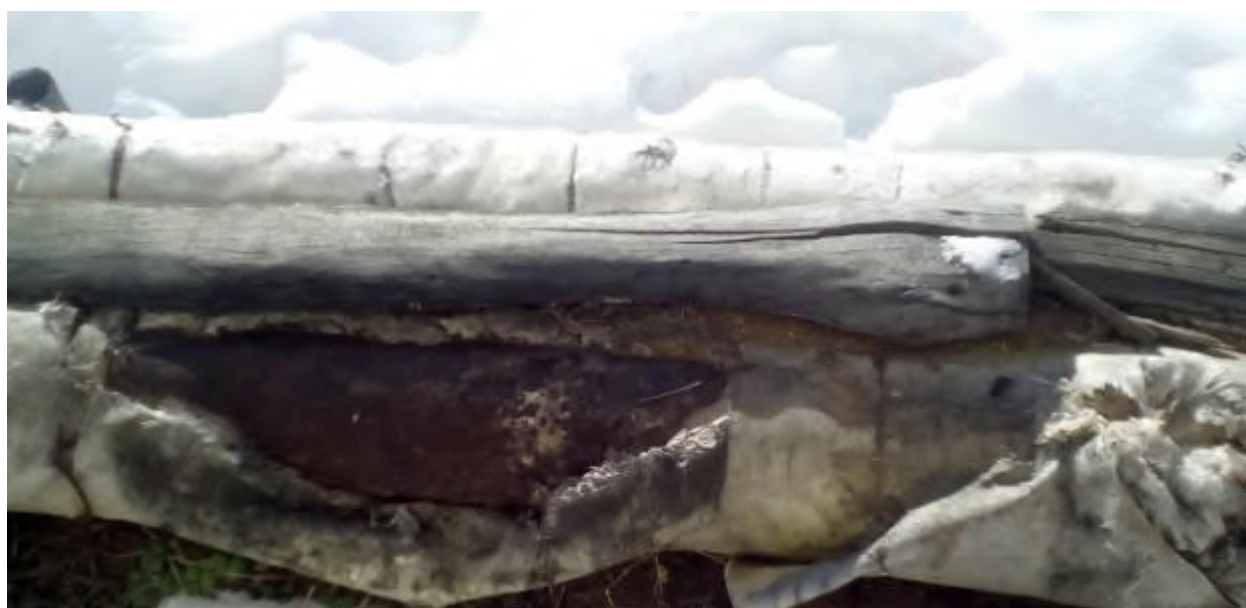
Рис. 3.18. Участок №14 тепловой сети котельной мкр-на ДОЗ
