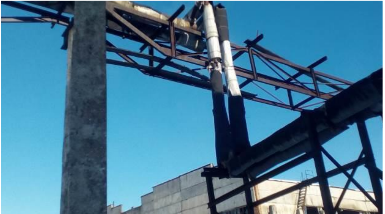
Рис. 3.9. Участок №2 тепловой сети котельной мкр-на ДОЗ
