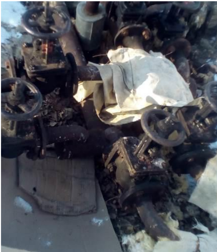
Рис. 3.26. Участок №10 тепловой сети котельной ул. Десантная
