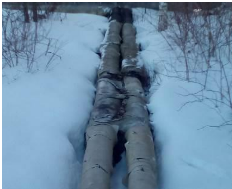
Рис. 3.21. Участок №3 тепловой сети котельной ул. Десантная
