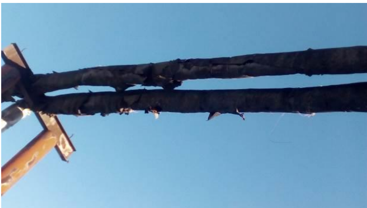
Рис. 3.32. Участок №21 тепловой сети котельной ул. Десантная
