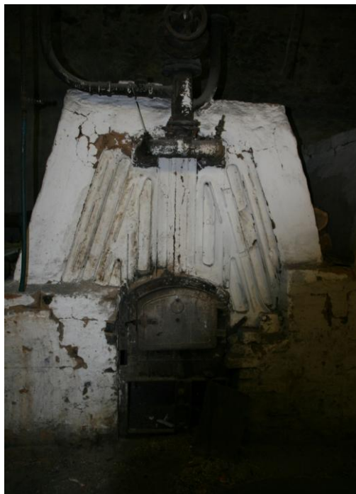
Рис.№2. Фотография котла, на котором проводились испытания
